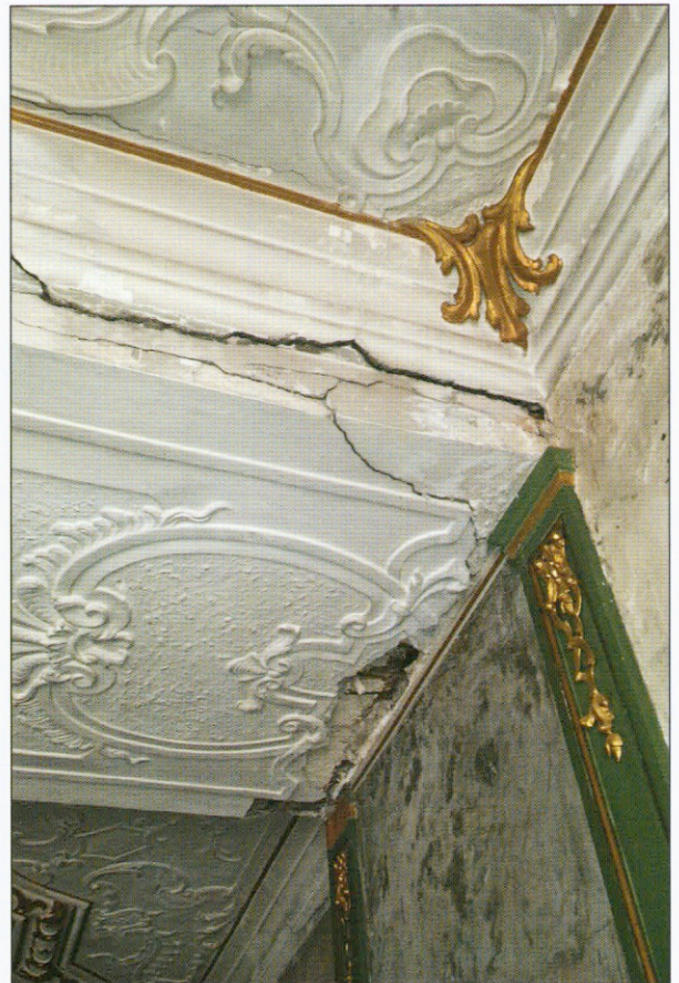
Abb. 2 Molsdorf, Schloss, 1. Obergeschoss, Risse aufgrund von Schäden im Dachtragwerk, 2021
